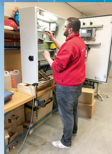
Schakelkasten worden in eigen werkplaats gebouwd en getest.
