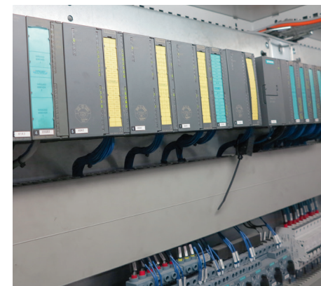
Binnenzijde van de besturingskast met gedeelte van de plc.
